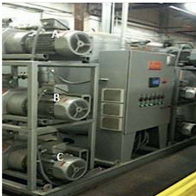
Points de mesures sur six moteurs identiques. Le niveau ultrasonore en dB ne diffère pas de plus de 3dB d'un moteur à l'autre sauf pour le moteur B. La mesure du moteur B était supérieure de 12 dB par rapport aux 5 autres moteurs
