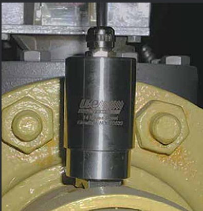
Exemple surveillance de roulement
