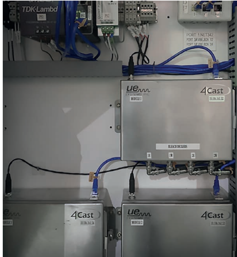
I sensori sono collegati a 4Cast, un'unità di elaborazione centrale con connessione a internet
